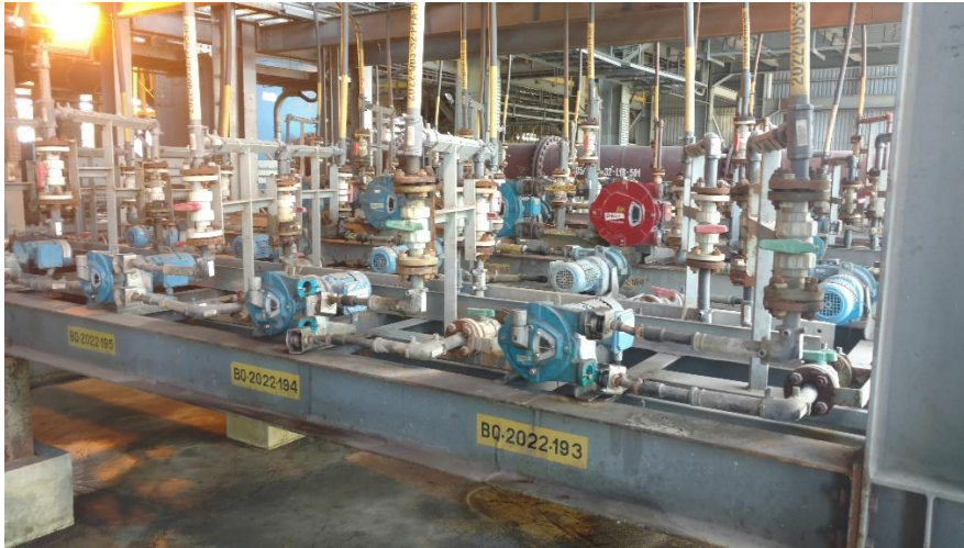
Figura 10. Sistema de dosagem de reagentes da usina do Salobo
