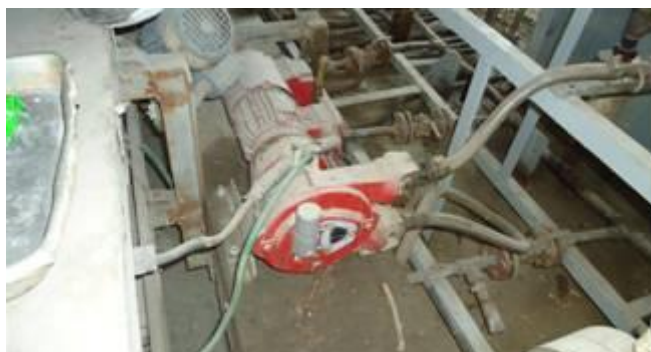
Figura 5. Bomba peristáltica SPX10 instalada na área
