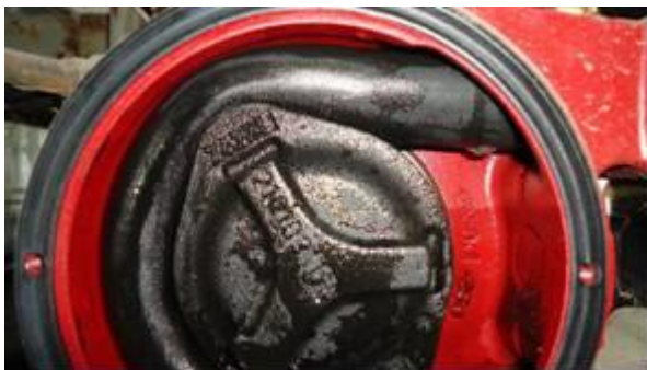
Figura 7. Detalhe da mangueira da bomba peristáltica após 8 meses de operação
