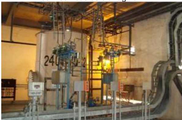
Figura 3. Sistema de dosagem de reagentes com bombas centrífugas
