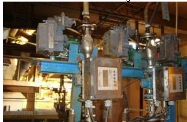
Figura 4. Sistema de dosagem de reagentes com bombas centrífugas
